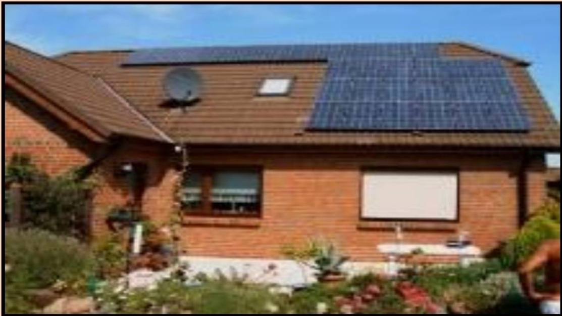
Solaranlage auf einem Einfamilienhaus in Ribnitz-Damgarten. Foto: Eckart Kreitlow
